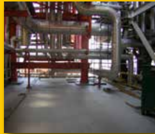
ENEL POWER - ITALIA -
